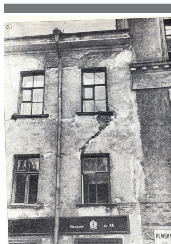
Рис. 1. Трещины в перемычках оконных проемов
