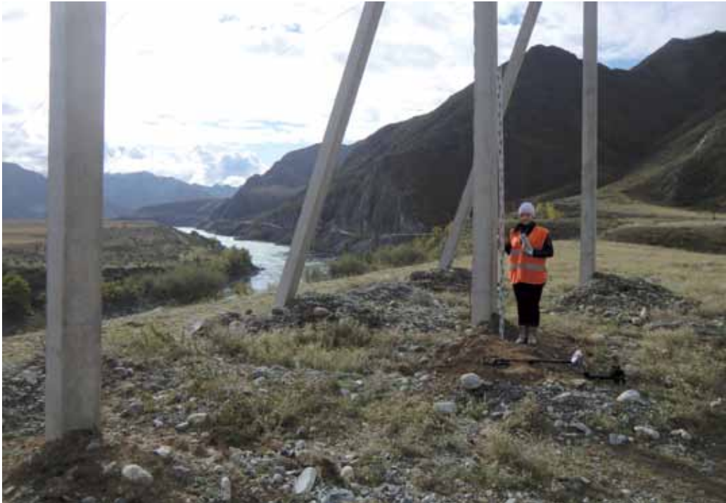
Рис. 3 (фото). Кур-Кечу-V. Объект №134, разрушенный при строительстве опоры ЛЭП (фотоснимок сделан с северо-востока)
